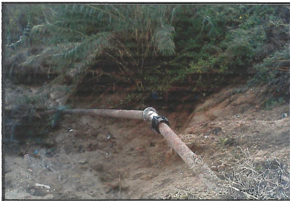
Foto n° 2 – materiale franato incanalato nell'impluvio a fondo valle
