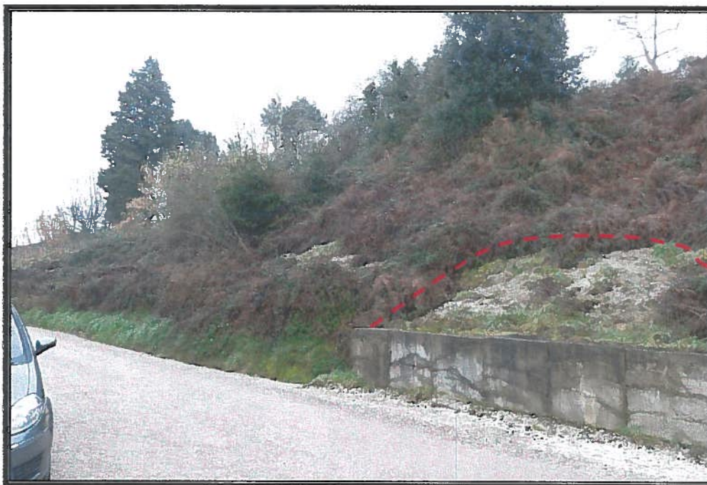
Foto n° 4 – stato attuale della parte del versante interessata dal dissesto nell'anno 2007
