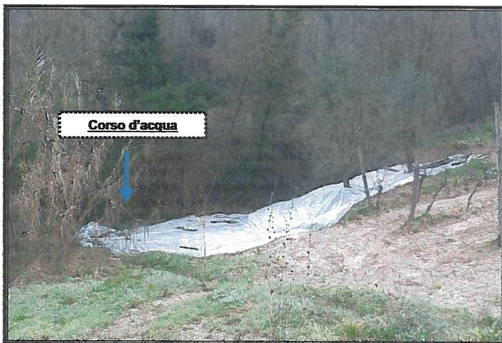
Foto n° 4 – panoramica del movimento gravitativo ai piedi del versante
