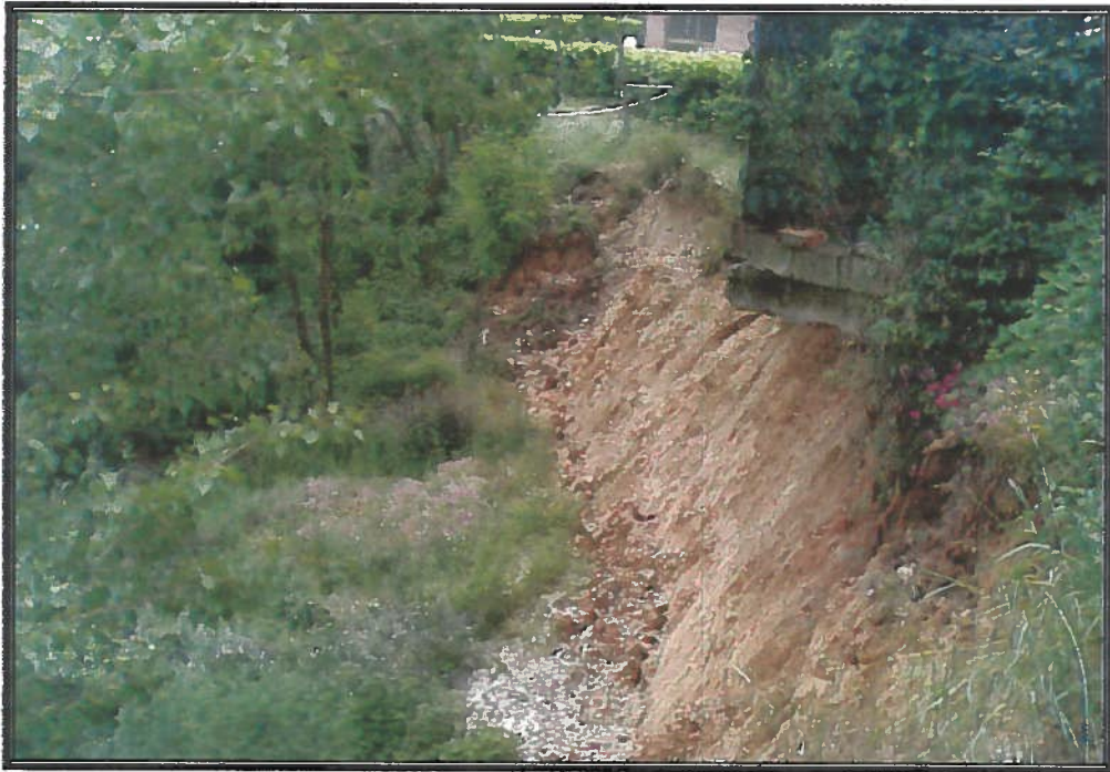
Foto n° 1 – coronamento e scarpata del movimento franoso
