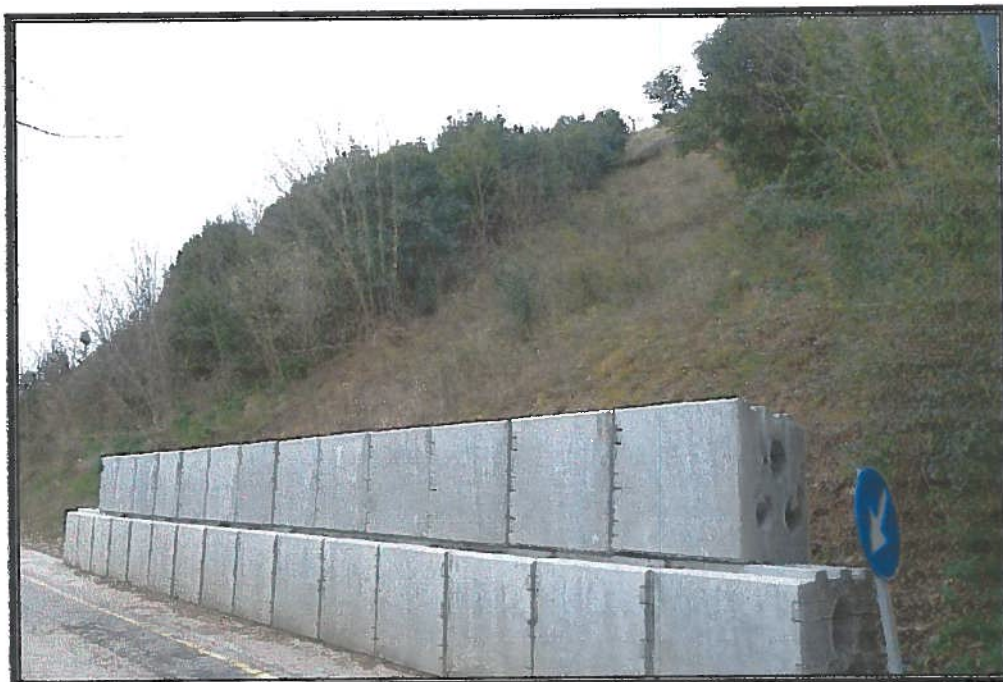
Foto n° 9 – particolare dell'opera di contenimento in geoblock eseguita in conseguenza del primo evento franoso di marzo 2013
