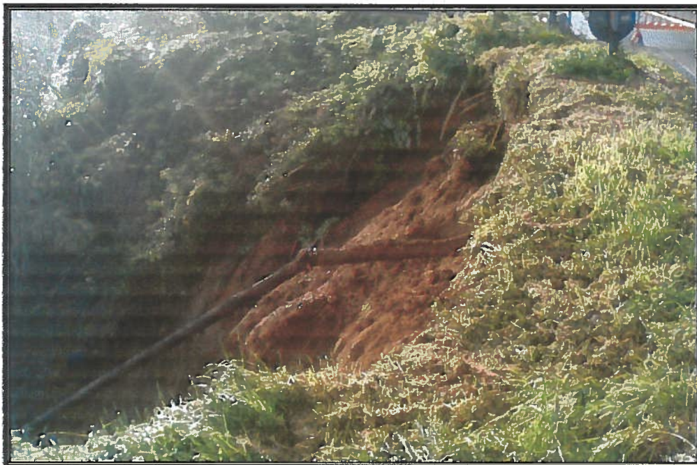
Foto n° 1 – coronamento e scarpata del movimento franoso
