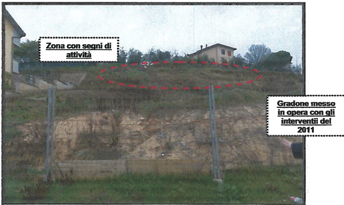
Foto n° 3 – situazione attuale del versante con presenza di dilavamenti canalizzati e piccoli smottamenti
