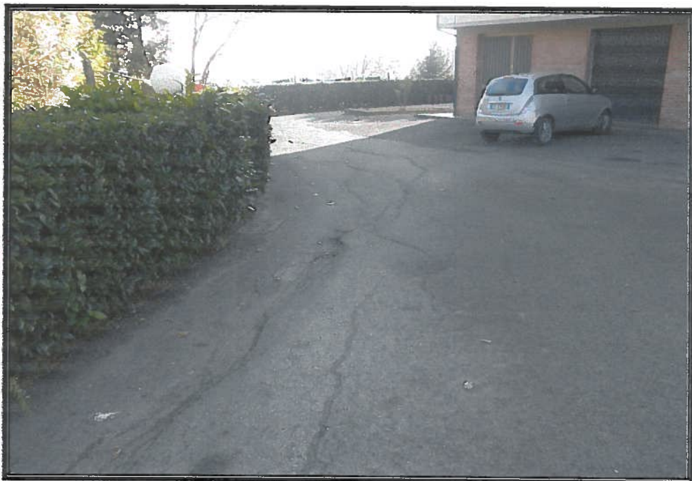
Foto n° 4 – lesioni sul piazzale sovrastante il versante in frana
