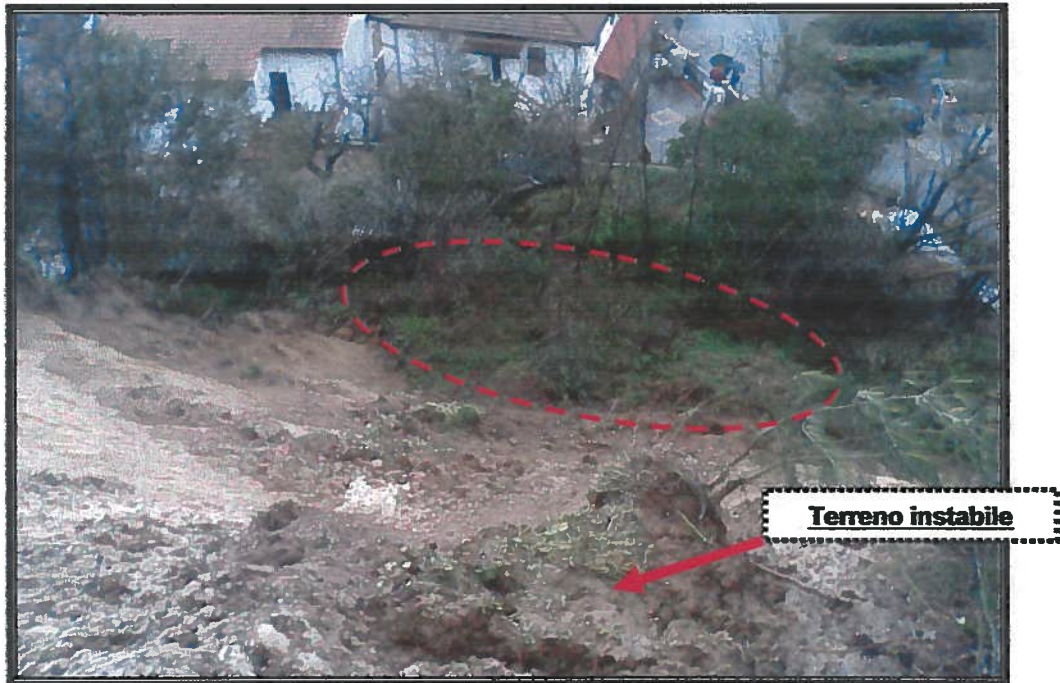
Foto n° 3 – accumulo del materiale di frana al piede del versante
