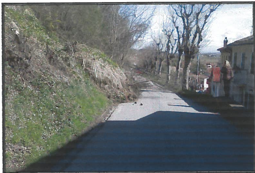
Foto n° 2 – corpo di frana
