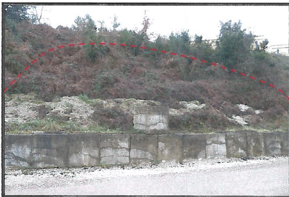
Foto n° 3 – stato attuale della parte del versante interessata dal dissesto nell'anno 2006
