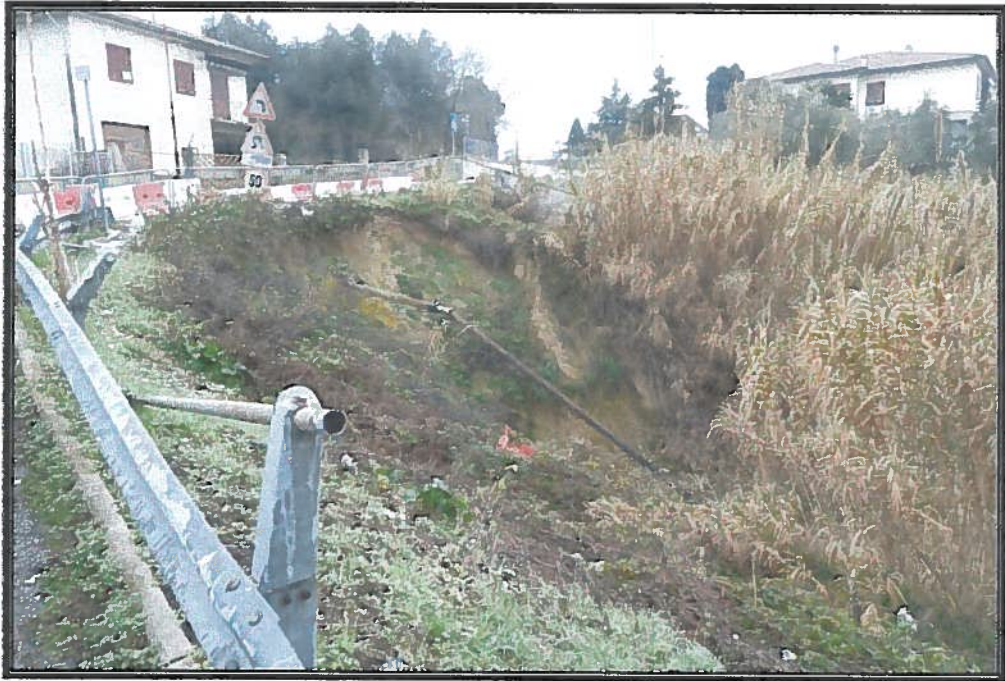
Foto n° 3 – stato attuale del fenomeno franoso
