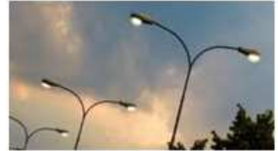
IMPIANTO DI PUBBLICA ILLUMINAZIONE
