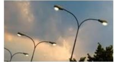
IMPIANTO DI PUBBLICA ILLUMINAZIONE
