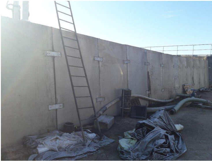
Chiusura fronte vasca con manufatti in cemento collegati da bande metalliche
