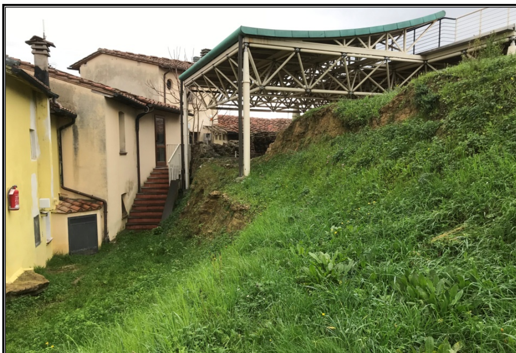
Foto 2 Come si presenta oggi (gennaio 2022) l'area dell'intervento in oggetto. Nelle parti più ripide, non inerbite è possibile osservare i depositi limi sabbiosi, con lenti di materiale arenaceo.
