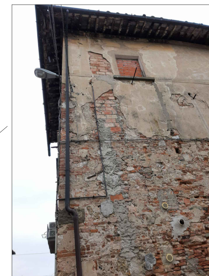
Lesione in facciata Est
