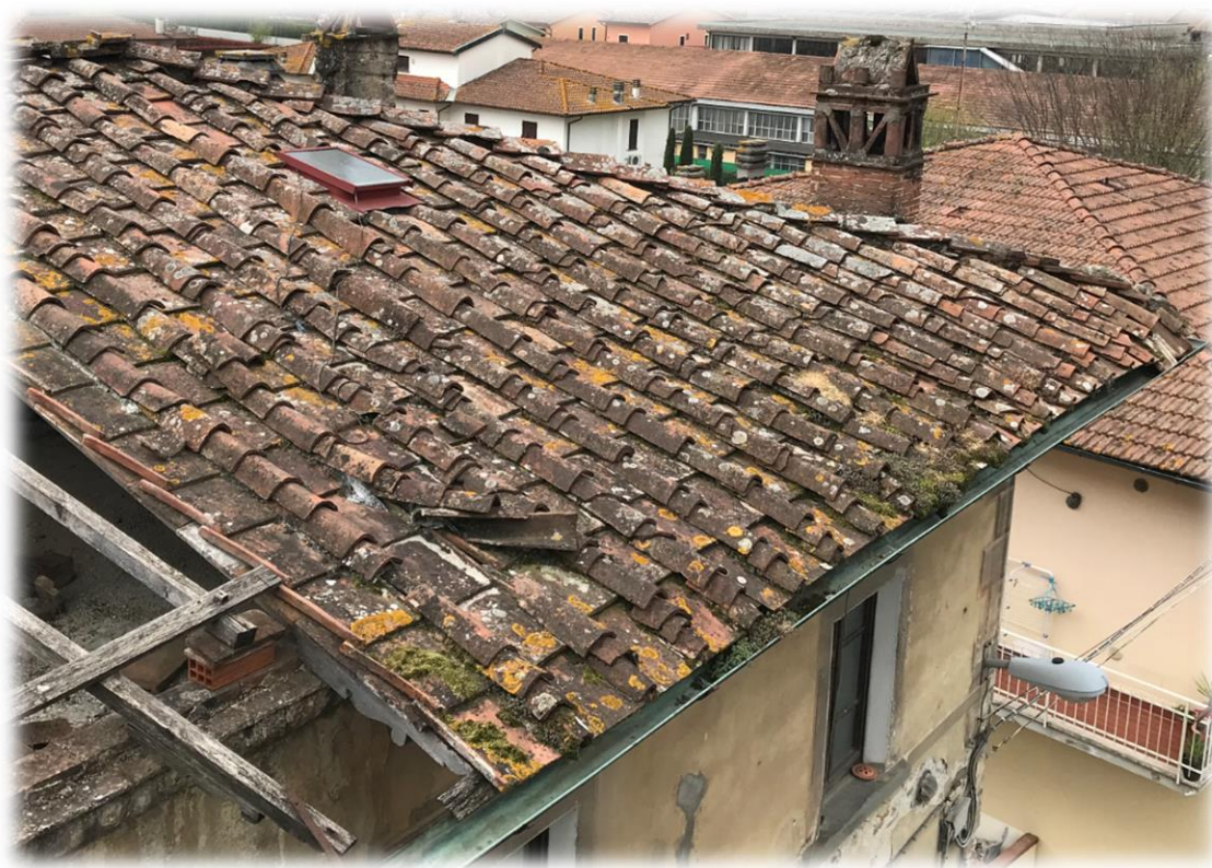
Figura 3 - Porzione di gronda pericolante da rimuovere
