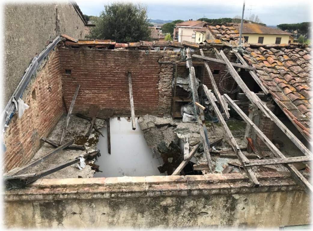
Figura 4 - Vista dall'alto della porzione di solai crollata
