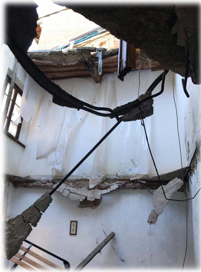
Figura 5 - Solai crollati con parti ancora pericolanti da disaggiare
